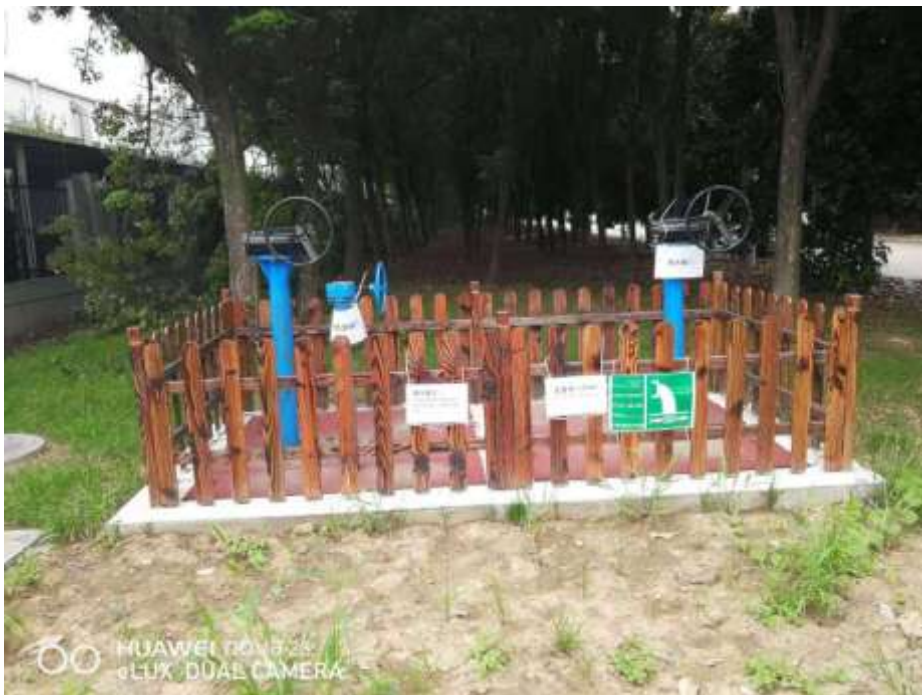
应急事故池及雨水口
