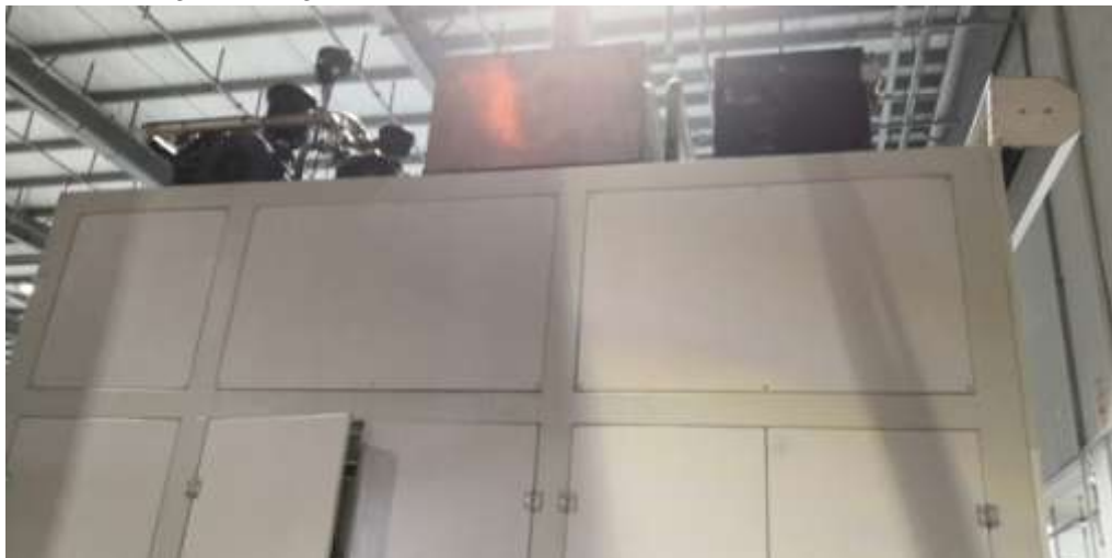
排气筒 FQ-2 进口在清洗设备内部，不具备监测条件
