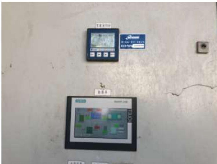
污水站显示系统
