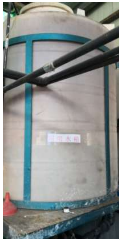
污水站回用水箱
