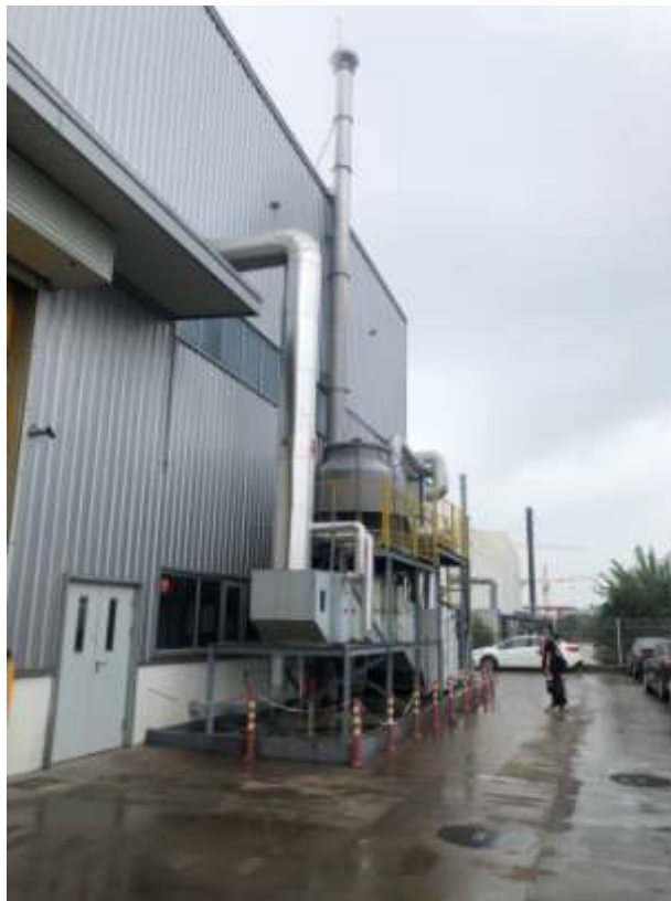
静电除油+沸石转轮浓缩+催化燃烧废气装置
